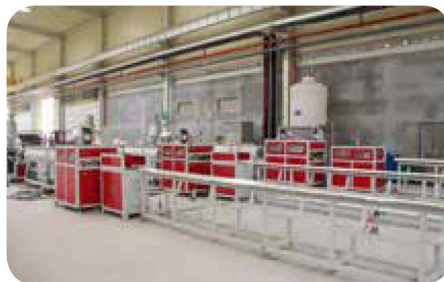
PE Pipe Line
